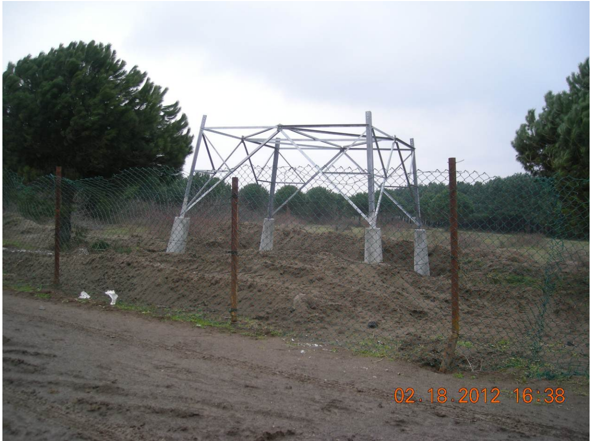
Şekil 55 - Devam Etmekte Olan Alan İçerisindeki Enerji Nakil Hattı
